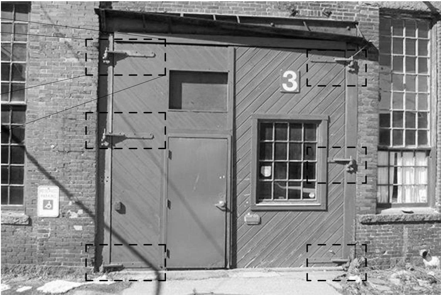
BLDG 3: DOOR HINGES, (6)
